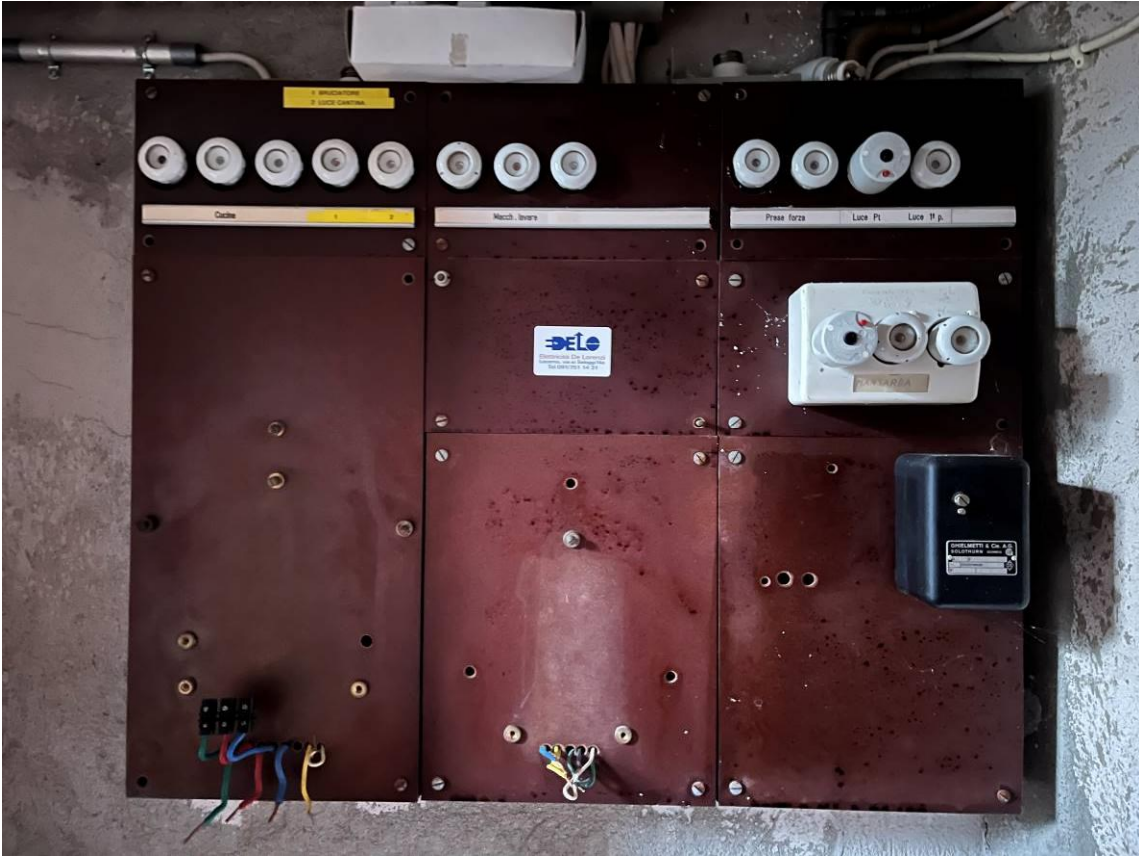
Foto 9: quadro elettrico disattivato
