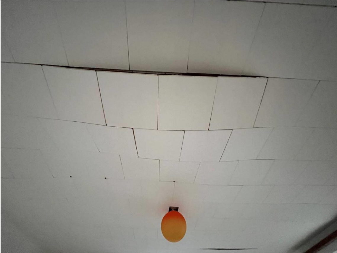
Foto 2: soffitto rotto del soggiorno al piano terreno
