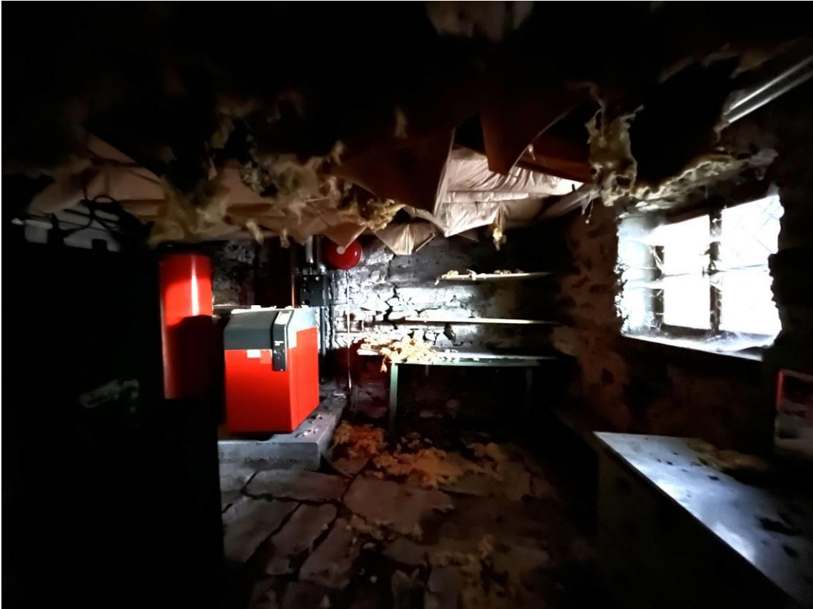
Foto 11: locale riscaldamento / isolamento termico del soffitto distrutto
