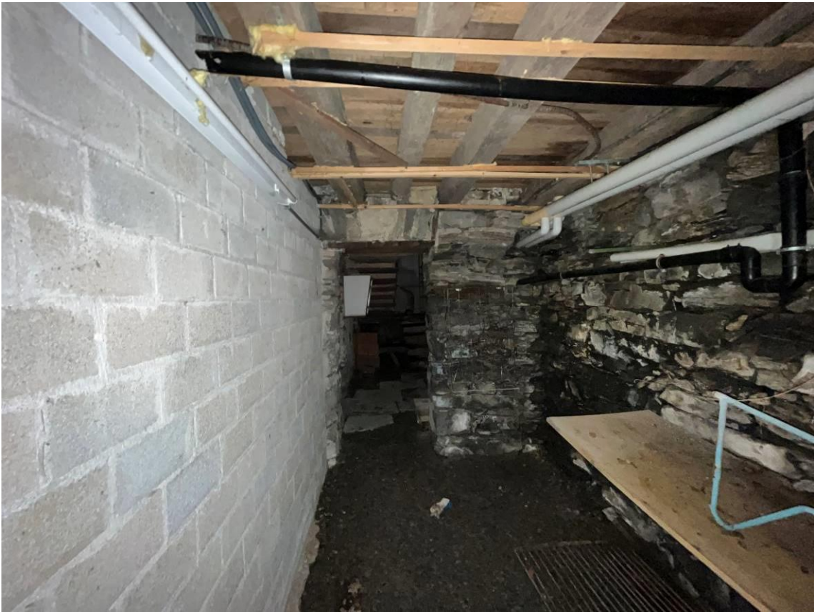
Foto 10: lavanderia al piano cantina
