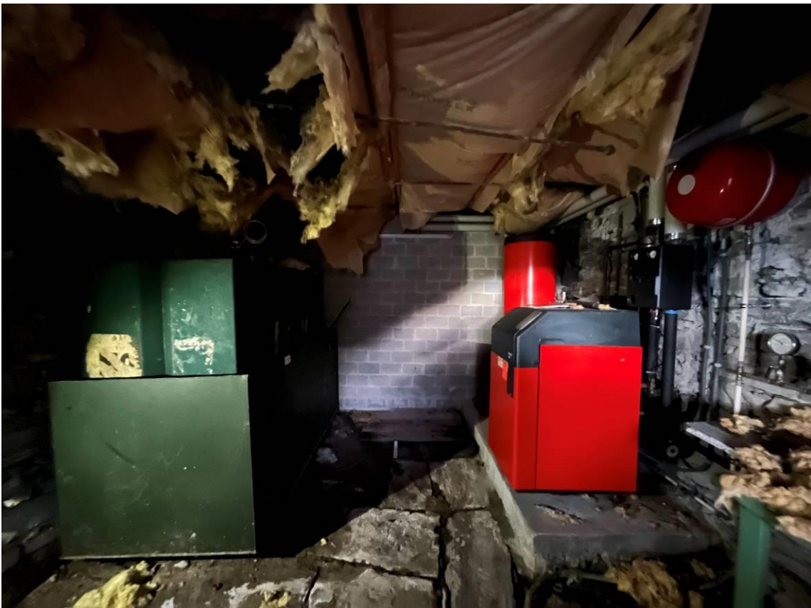
Foto 12: tank e caldaia
